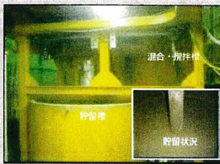
A材の混合、貯留槽
