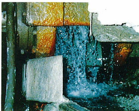
地下水噴発状況
